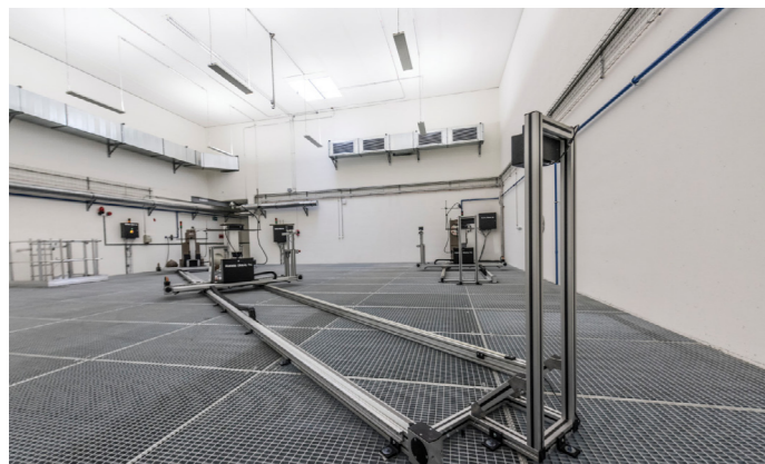
Une nouvelle installation de vérification des appareils de mesure des radiations a été mise en service. (CERN-PHOTO-201411-230-2)
