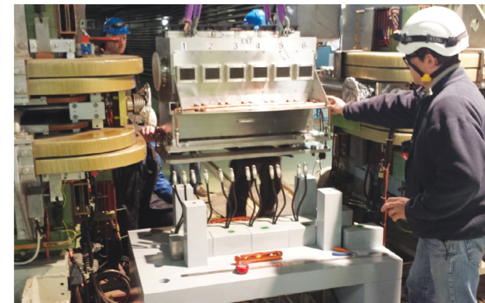
Installation d'une cavité FineMet dans l'accélérateur PS pour la stabilisation des faisceaux à haute intensité. (OPEN-PHO-ACCEL-2016-003-5)
