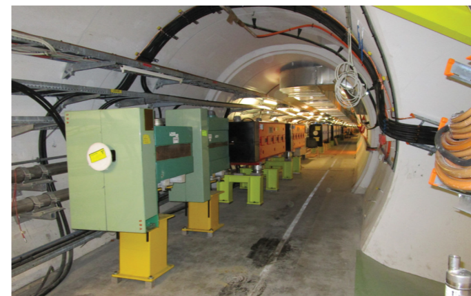
La ligne de faisceau qui dirigera les protons du SPS vers la nouvelle installation AWAKE a été installée. (OPEN-PHO-ACCEL-2016-008-1)
