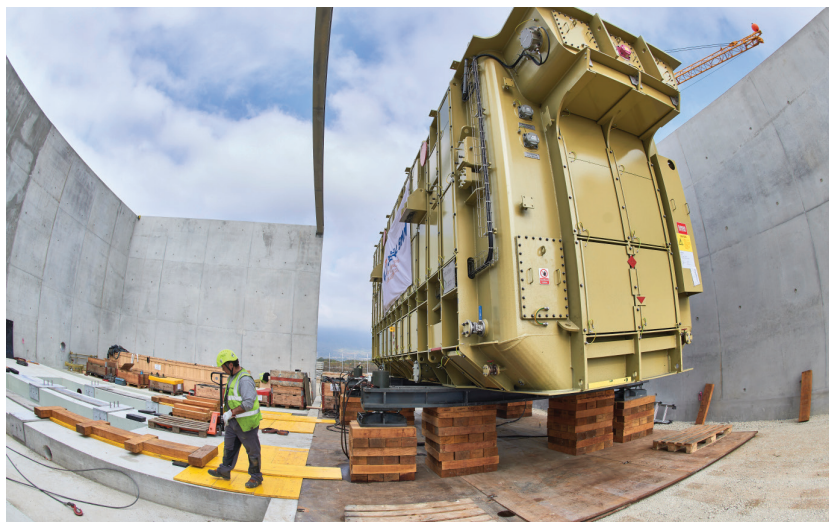
Un nouveau transformateur de puissance de 400 kV, le plus grand du CERN, a été livré pour renforcer l'infrastructure électrique du Laboratoire.
