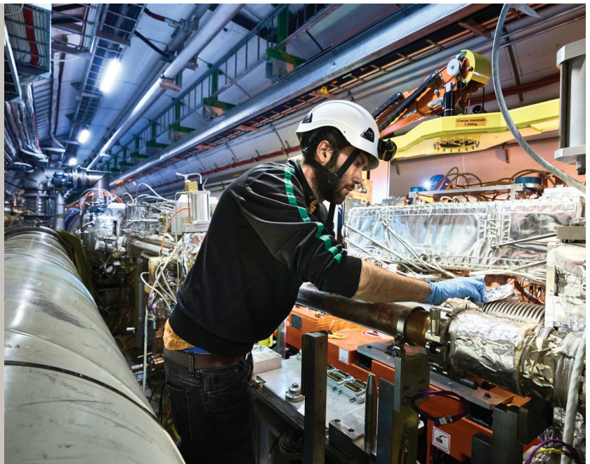
De nouveaux collimateurs développés pour le LHC à haute luminosité ont été installés dans le LHC, dont deux exemplaires près de l'expérience ATLAS. (CERN-PHOTO-201801-011-1)
