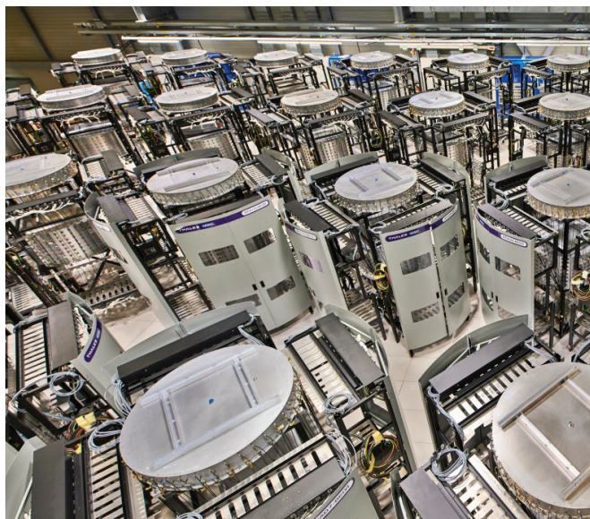
Installation du nouveau système d'amplificateurs à transistors développé pour les cavités accélératrices du SPS.
