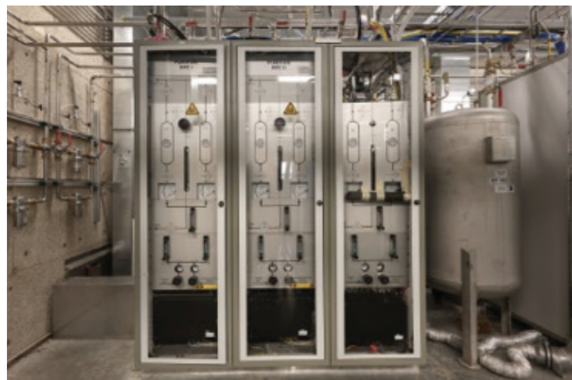
UNE CENTRALE DE RÉCUPÉRATION DE HFC-134A INSTALLÉE AU POINT 5 DU LHC.
