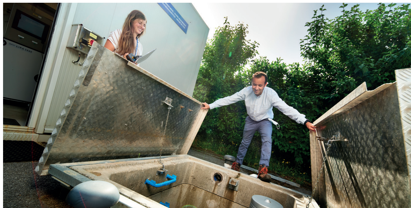
LA STATION DE CONTRÔLE DES EAUX, sur le site de Meyrin, possède un système de détection des hydrocarbures.
