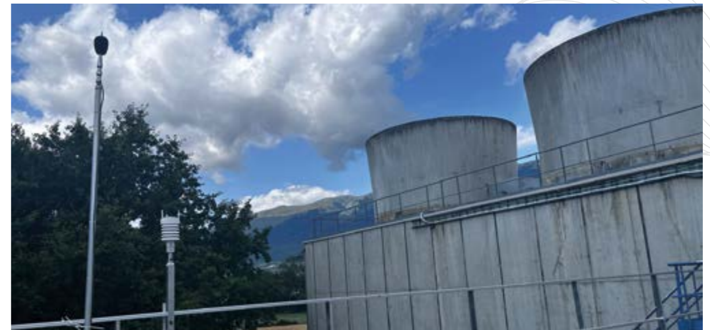
Contrôle du bruit généré par les tours de refroidissement au point 2 du LHC
