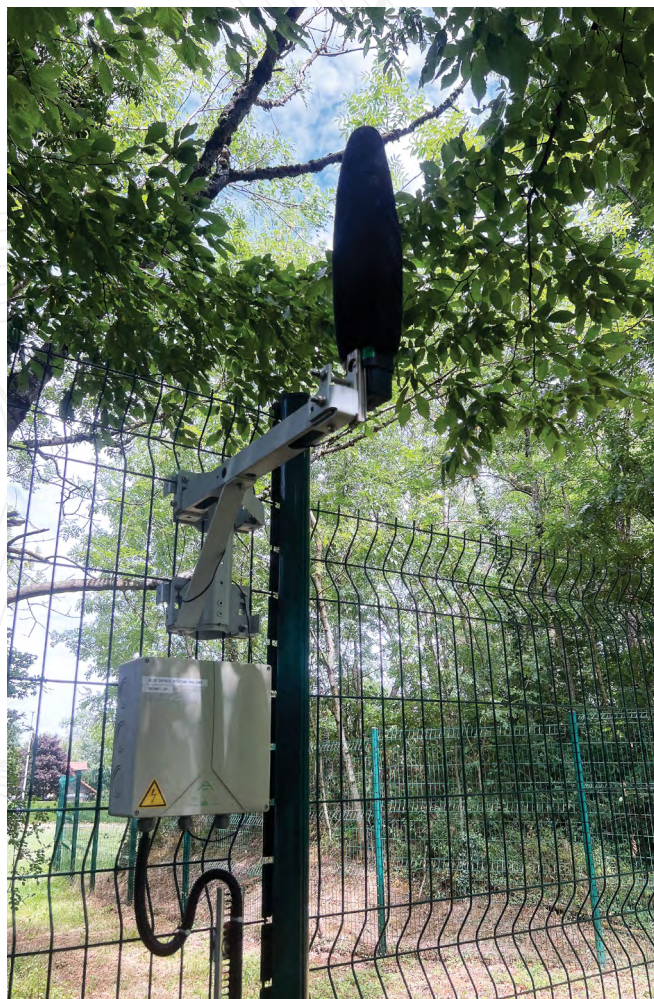
Station de surveillance du bruit au point 4 du LHC (Échenevex, France).
