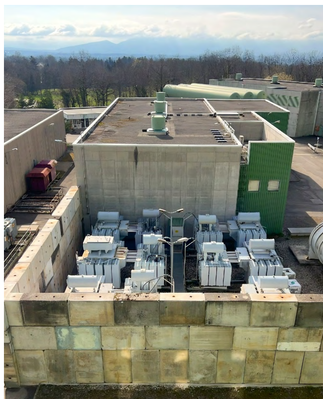
Barrières acoustiques installées au point 4 du LHC (Échenevex, France) pour réduire le bruit des transformateurs électriques.
