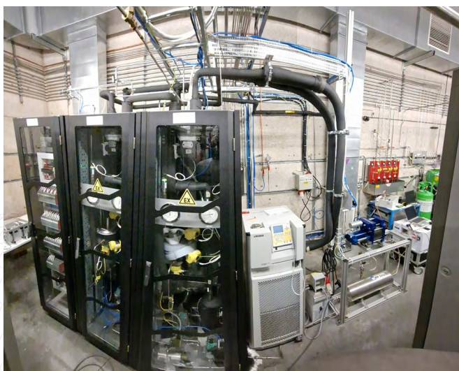
Première station de récupération du HFC-134a pour le mélange de gaz des chambres à plaques résistives, opérationnelle à l'expérience CMS depuis 2024.
