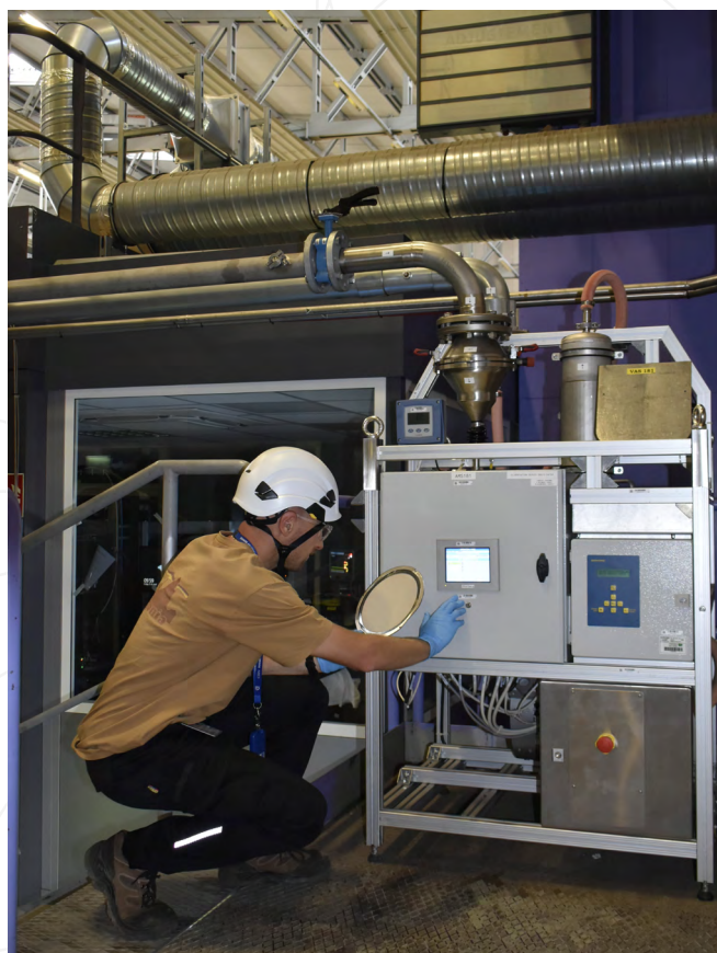
Station de surveillance de la ventilation sur le site de Meyrin.
